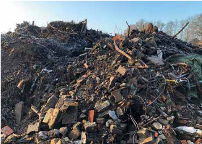
Auffüllungen mit Fremdbestandteilen (Müll) beim Bodenaushub.
