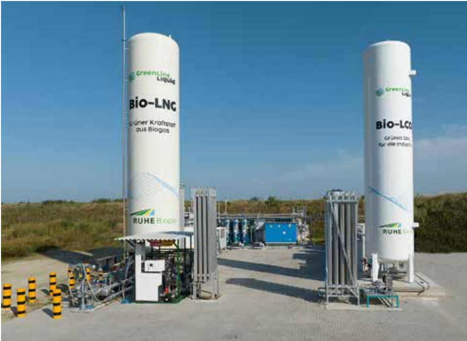
Deutschlands erste Bio-LNG-Kompaktanlage in Darchau, Landkreis Lüneburg.
