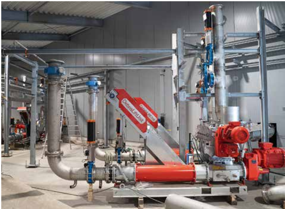
Insgesamt investiert nordfuel einen dreistelligen Millionenbetrag in das Werk im c-Port. Der Technikaufwand ist beträchtlich – auch für die Reinigung des Wirtschaftsdüngers (Bild unten). Bevor die Gasgewinnung in der Fermentation beginnt, wird der Dünger geschreddert; an dieser Stelle fallen kleine Steine heraus.
